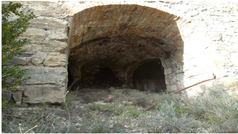
L'entrée du four
