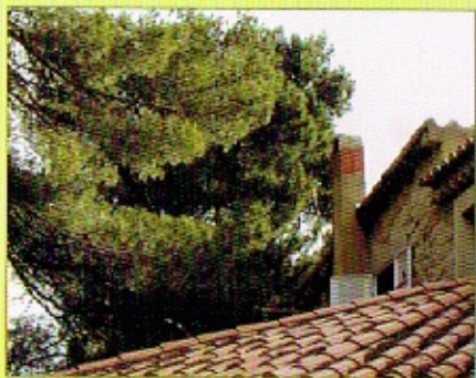
Enlever toute branche surplombant le toit.
